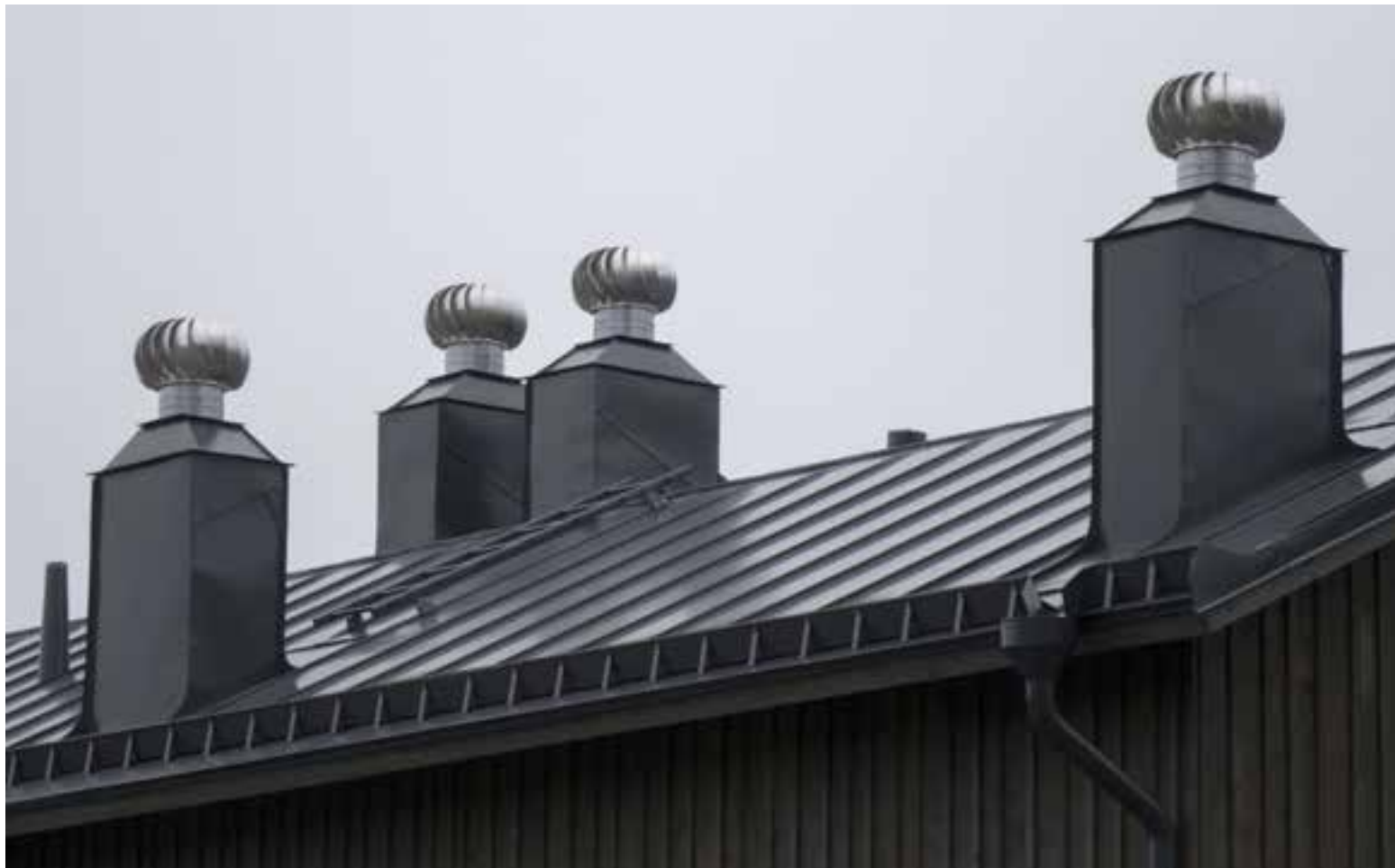
Ventilationen sker inte med elmotorer, utan med de här vinddrivna utsugsventilerna.
